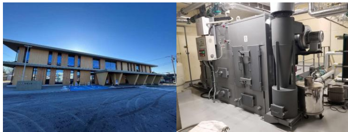
役場庁舎 ペレットボイラー 232kW R3.5.6稼働開始
